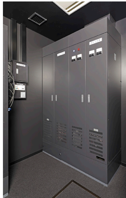
主幹電源盤・分岐盤
