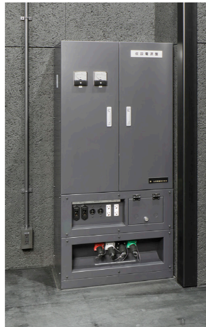
持込照明機器電源盤
