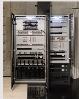
照明機器電源盤 3φ4W 37.5kVA ×2(負荷用) 1φ3W 40kVA ×2(持込用)
