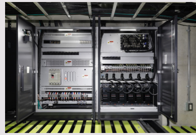
ずのこ電源盤 3φ4W 120kVA×2
