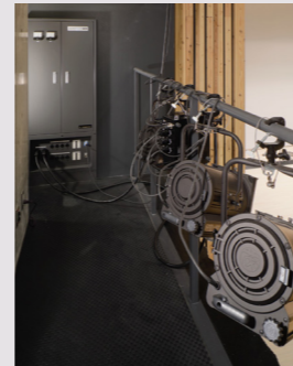
フロントサイドライト電源盤 1φ3W 20kVA×2
