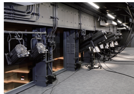
大ホール 第2シーリングライト/ピンスポットライト
